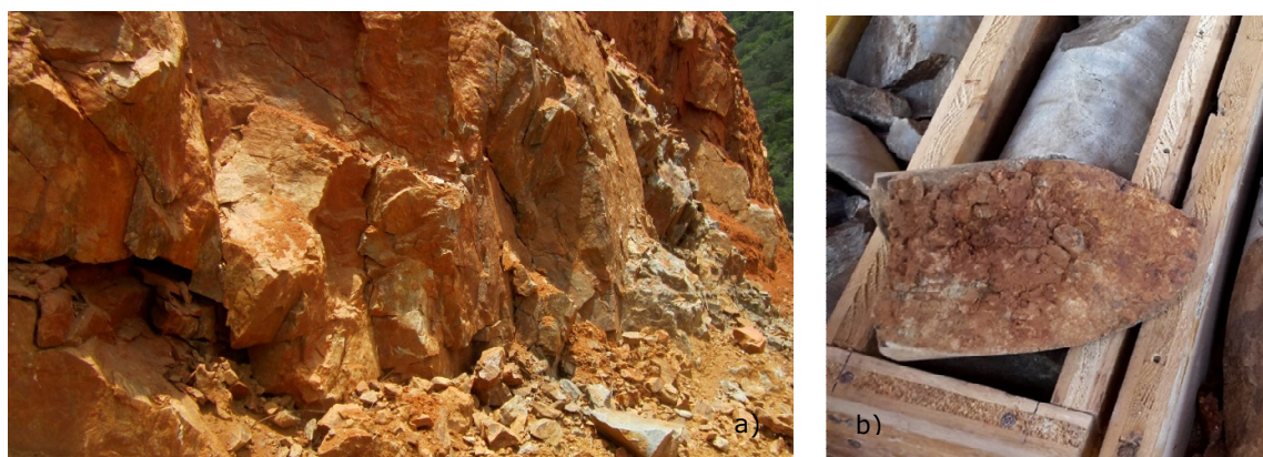
Figura 6 – Maciço gnaissico da encosta do parque de transformadores e comportas; a) Abertura acentuada de descontinuidades durante a escavação; b) Preenchimento de descontinuidades num tarolo de sondagem
